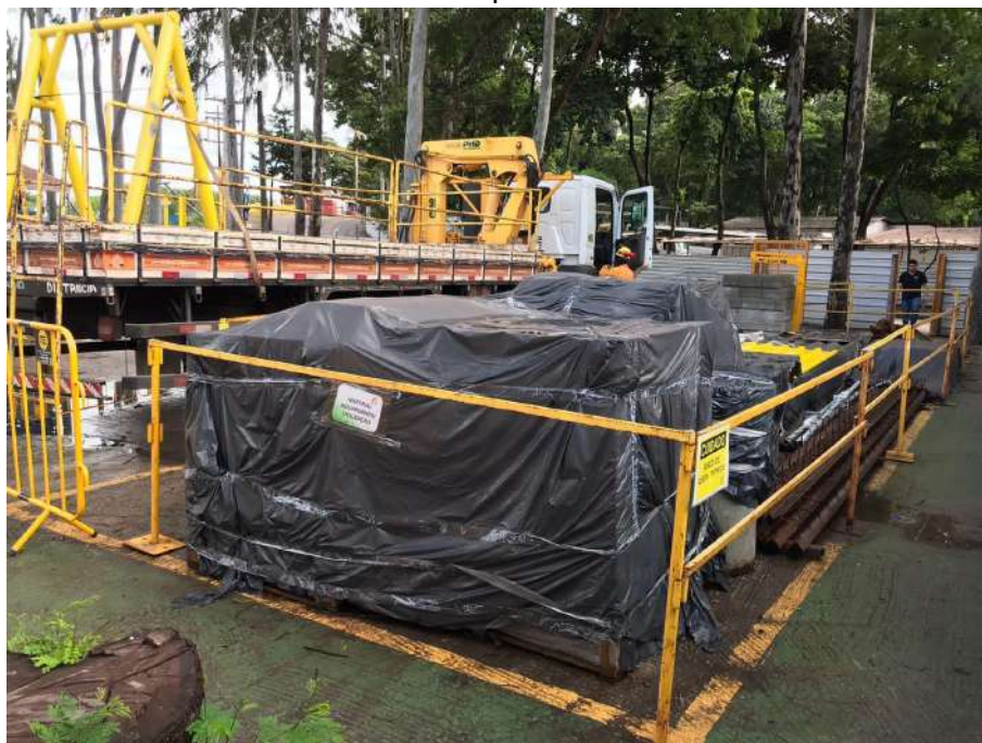
Figura 34 – Peças metálicas armazenadas em estoque descoberto e protegido contra intempéries.
