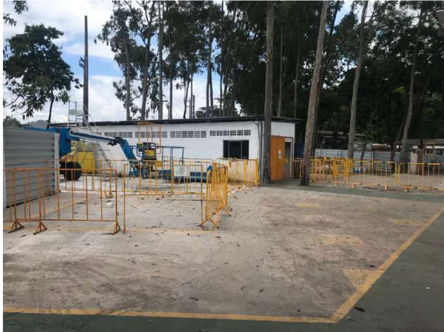
Figura 53 – Barreiras de proteção entre pedestres e equipamentos.
