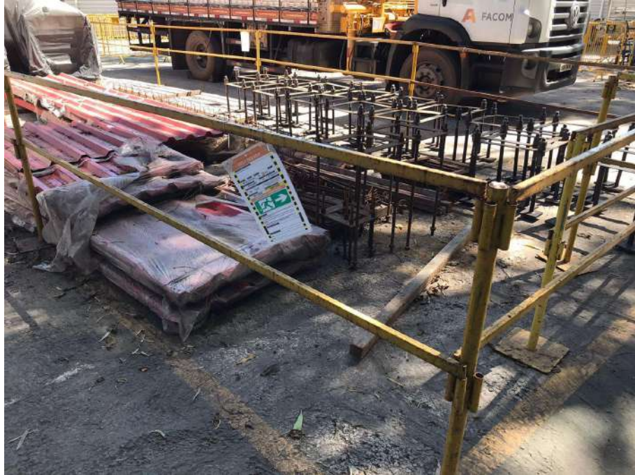
Figura 64 – Setorização de áreas de armazenamento.
