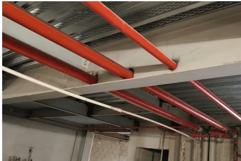
Figura 10 – Tubos de gás perfurando vigas metálicas
