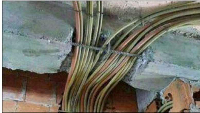
Figura 9 – tubulação furando viga estrutural
