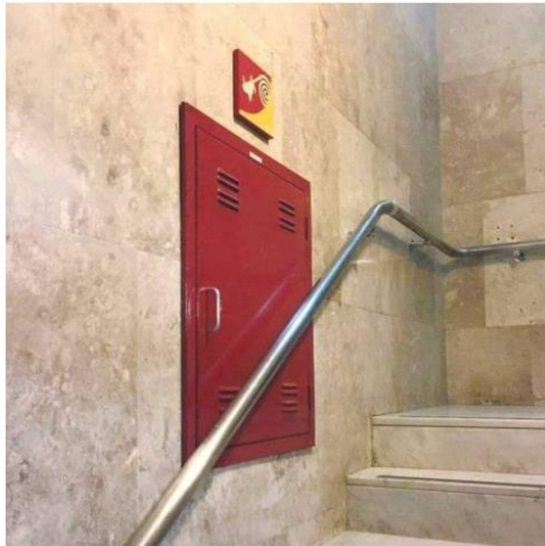
Figura 11 – incompatibilização entre corrimão e porta para mangote de incêndio
