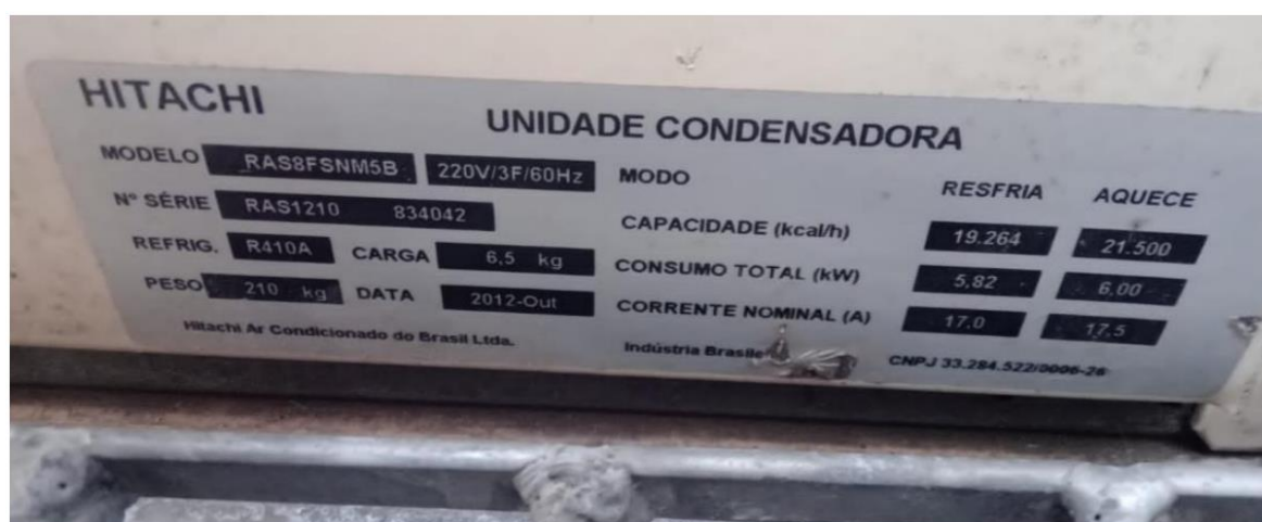
Figura 29 - Detalhe das condensadoras VRF instaladas na cobertura.
