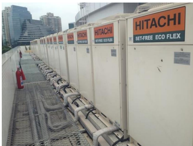
Figura 28 - Condensadoras VRF instaladas na cobertura.
