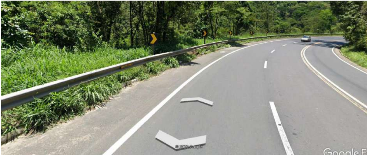
Figura 23 - Defesa metálica - Segmento 4,0
