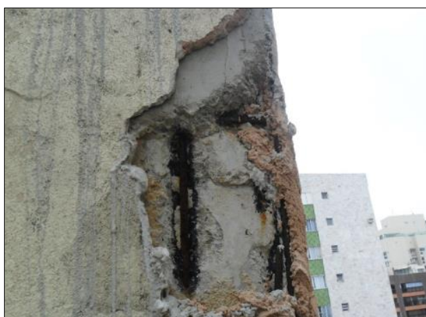
Figura 41 - Corrosão da armadura no Edifício A.
