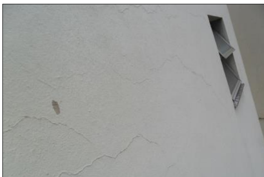
Figura 36 - Trincas diversas do Edifício A.
