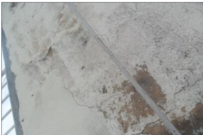
Figura 37 - Trincas verticais e horizontais do Edifício A.
