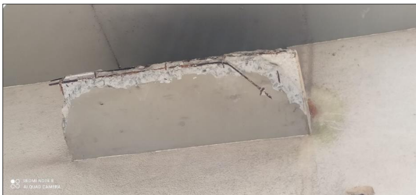
Figura 48 - Estrutura danificada devido à corrosão da armadura do Edifício A.
