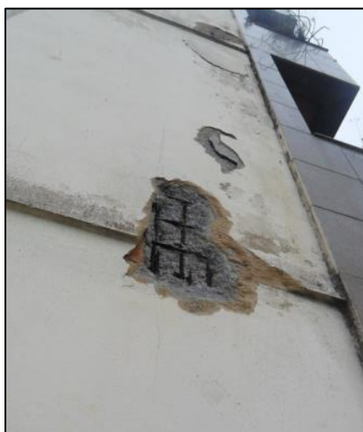
Figura 43 - Corrosão da armadura na fachada lateral esquerda do Edifício A.
