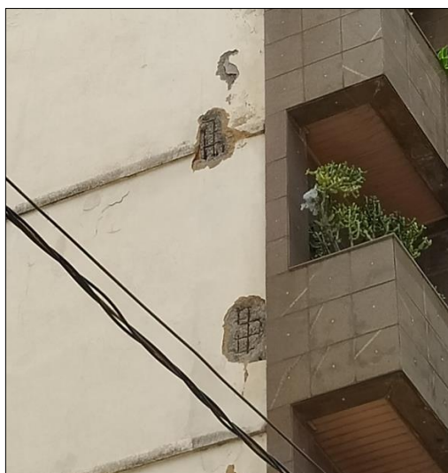
Figura 49 - Armadura apresentando corrosão no Edifício A.
