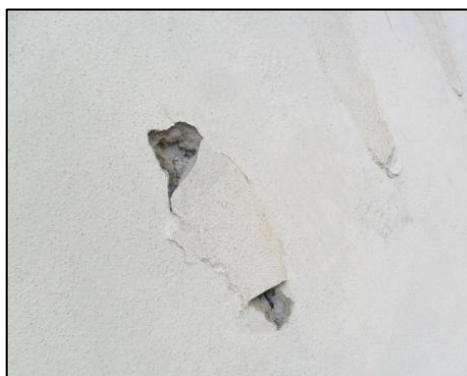
Figura 44 - Revestimento desprendendo devido a corrosão da armadura.
