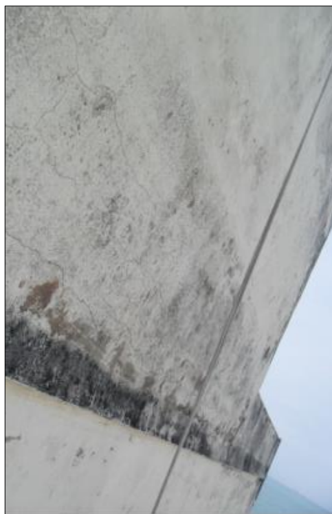
Figura 23 - Trincas diversas em fachada do Edifício A com revestimento desprendendo.
