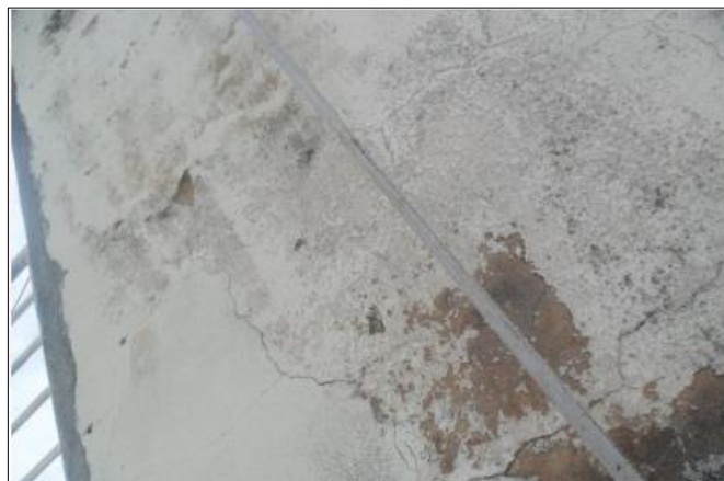
Figura 22 - Trincas diversas em fachada do Edifício A.
