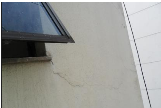
Figura 39 - Trinca diagonal do Edifício A.
