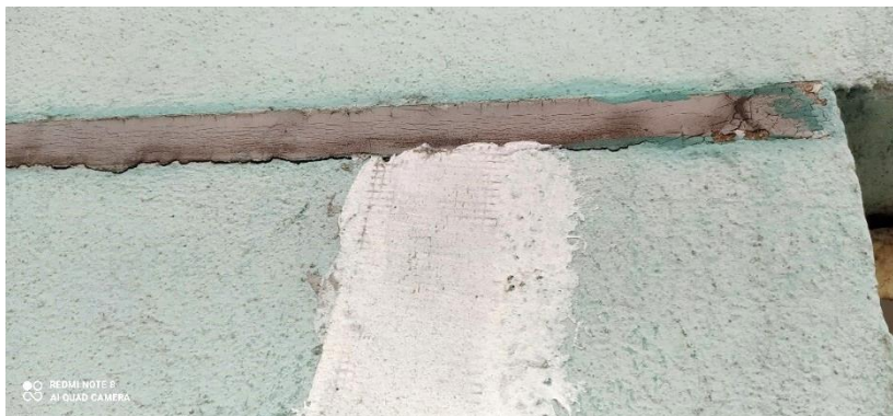
Figura 50 - Selante ressecado de junta de movimentação no Edifício B.
