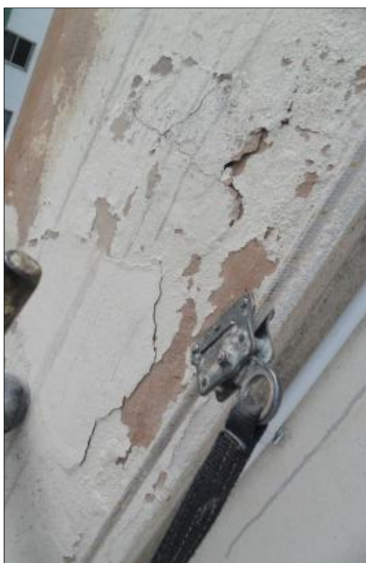
Figura 25 - Trincas diversas com revestimento e pintura desprendendo.
