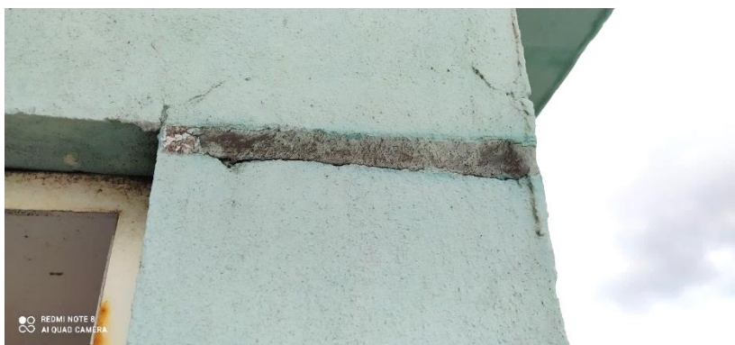
Figura 51 - Selante danificado em fachada do Edifício B.
