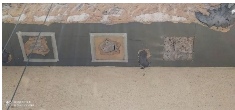
Figura 47 - Revestimento desprendido com oxidação da armadura do Edifício A.
