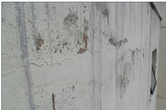
Figura 24 - Trincas horizontais com revestimento e pintura desprendendo.
