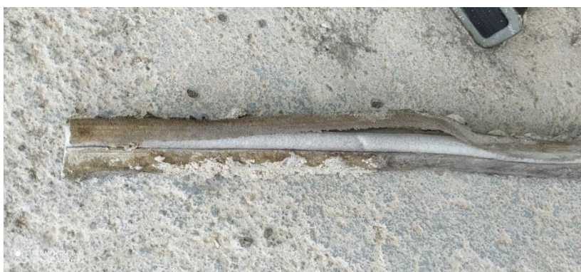
Figura 52 - Selante ressecado retirado da junta de movimentação do Edifício B.
