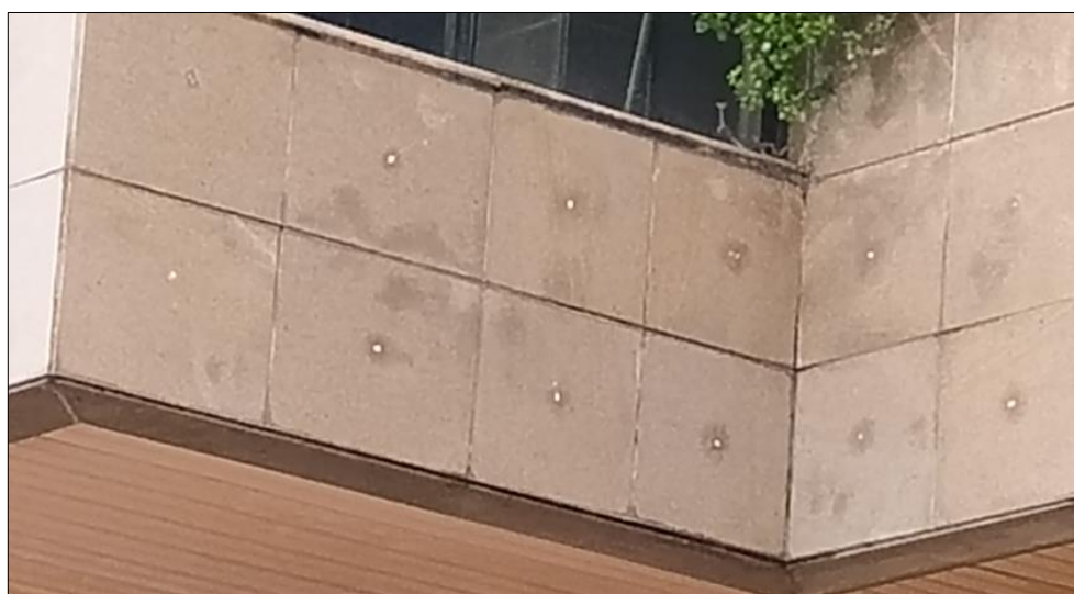
Figura 17 - Parafusos de fixação dos granitos da fachada frontal do Edifício A.
