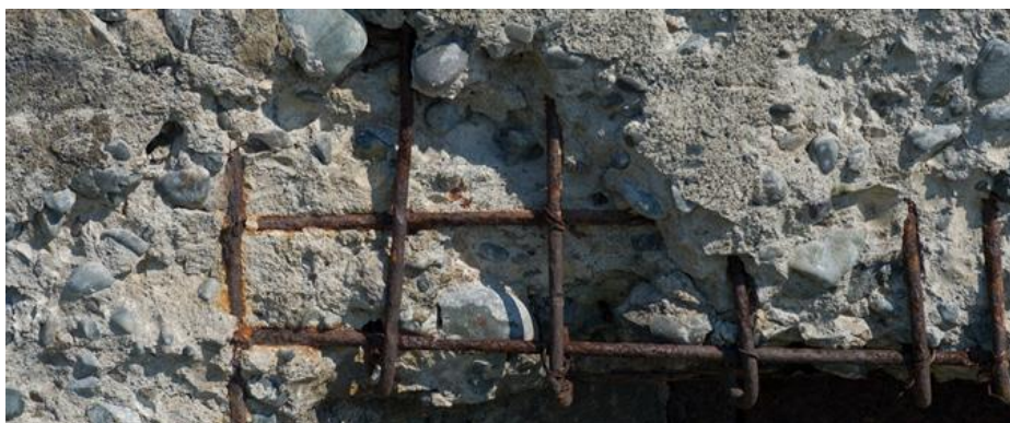
Figura 11 - Bicheiras na estrutura de concreto
