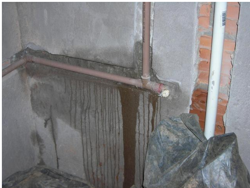
Figura 8 - Manchas ocasionadas por vazamentos hidráulicos
