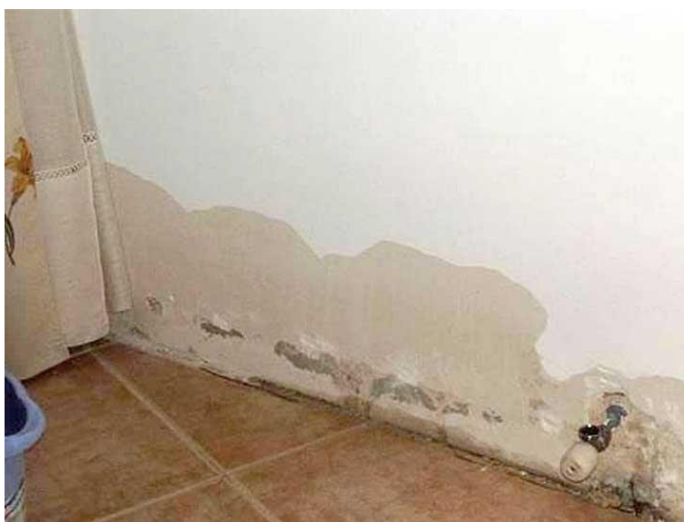
Figura 7 - Manchas causadas pela capilaridade.
