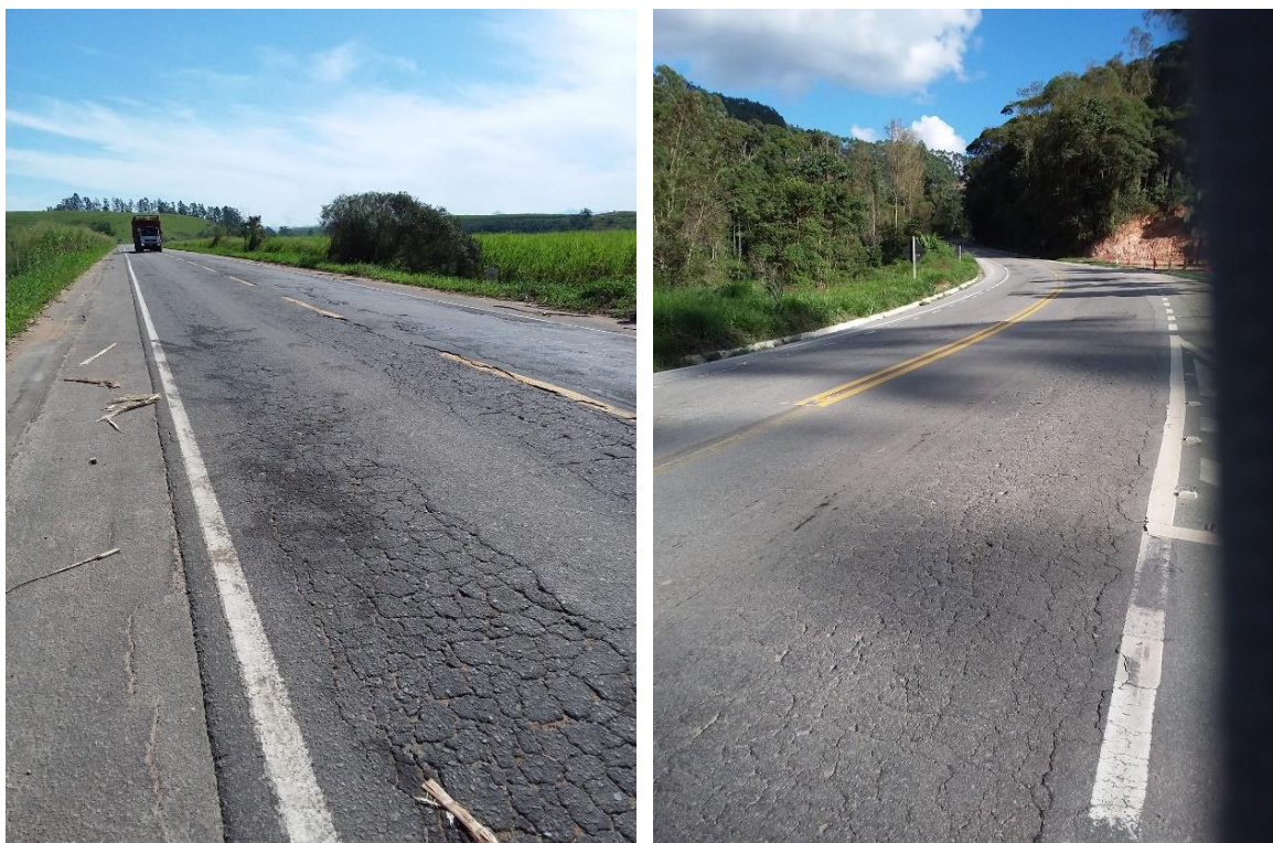
Figura 3- Trincamento excessivo na camada de revestimento asfáltico devido ao dano por fadiga em (a) Itapemirim-ES e (b) Brejetuba-ES
