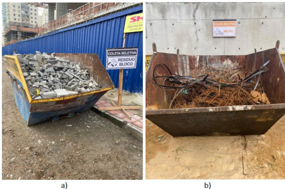
Figura 16 - Resíduo Classe A/B segregado em caçamba estacionária - Obra “B”.
