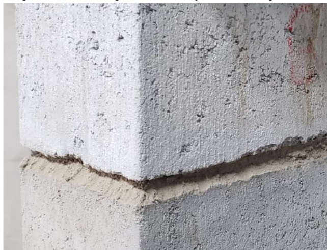
Figura 37 - Esmagamento das juntas de argamassa.
